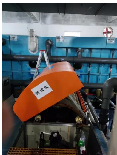
微滤机及生物滤池
