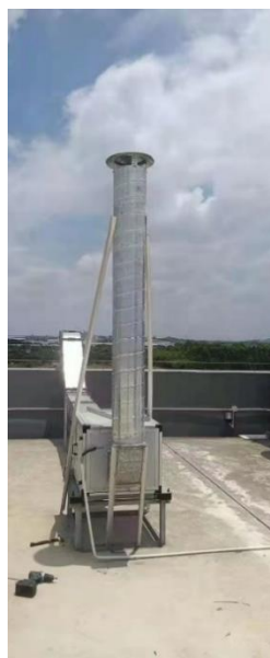
生物实验安全柜废气排放口
