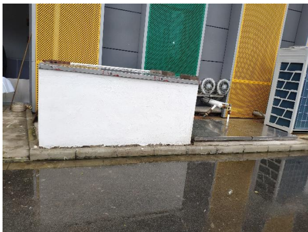
沉淀池+污泥池
