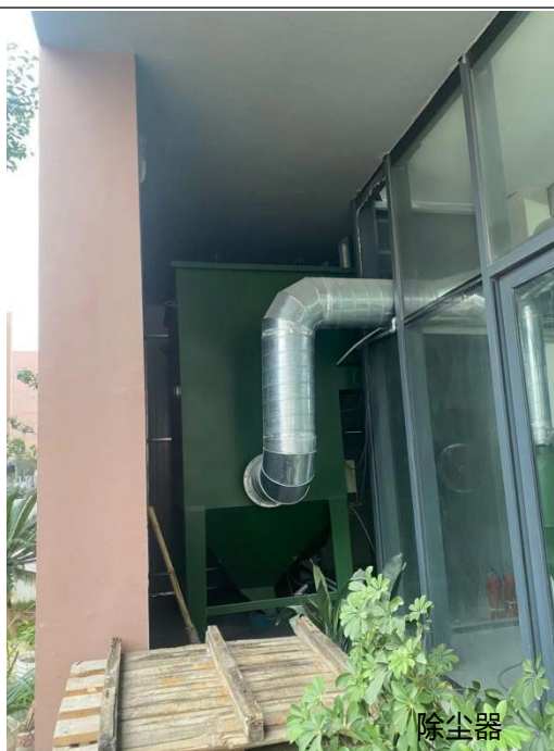
图 3-1 废气处理设施
