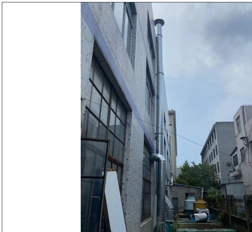
注塑机废气排气筒
