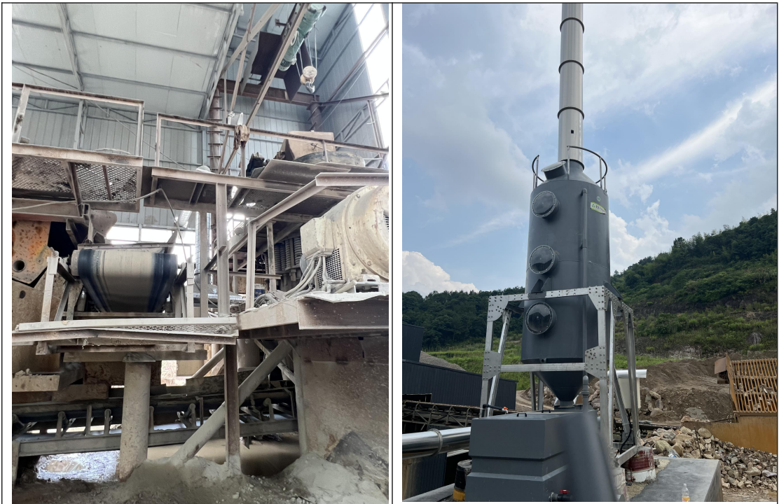
水喷淋（破碎制砂、筛选粉尘）
