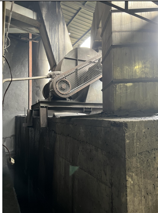
熔化、浇注、制芯废气（水池）
