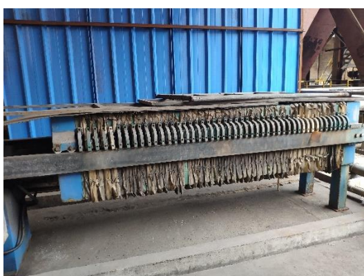
洗涤液处理设施污泥压滤机
