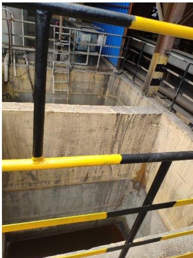
洗涤液收集处理设施
