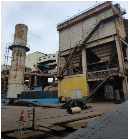
投料废气布袋除尘+排气筒
