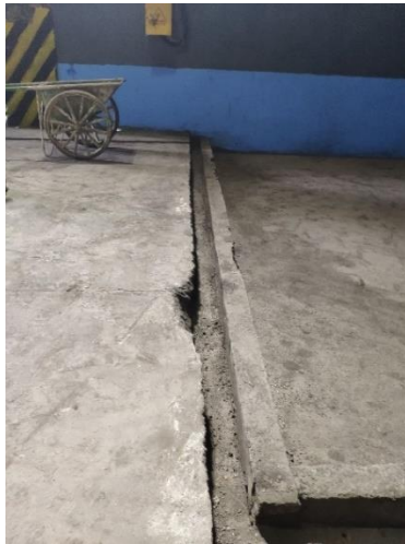
渗滤液收集沟
