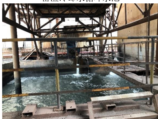
窑渣冷却水循环水池
