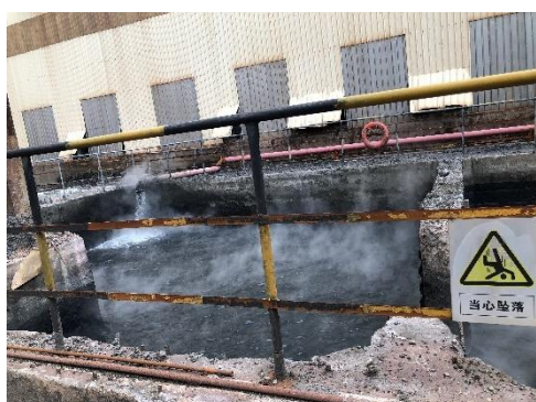
窑渣冷却水循环水池
