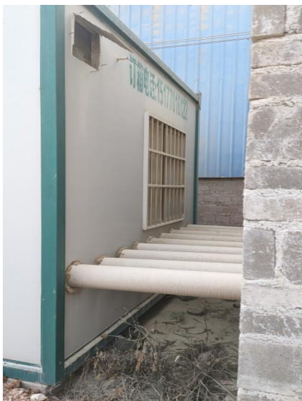
布袋除尘室连接喷淋室
