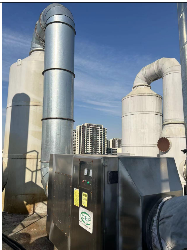
水喷淋+活性炭+光氧催化（面漆废气、粘合废气）
