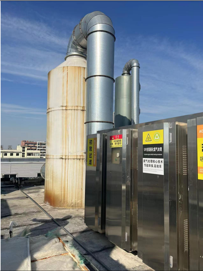
水喷淋+光氧催化+活性炭（底漆废气、调漆废气、晾干废气）
