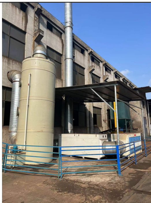
浇铸废气（水喷淋+光氧气+活性炭）
