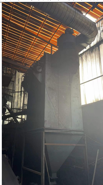
打箱落砂（布袋除尘）
