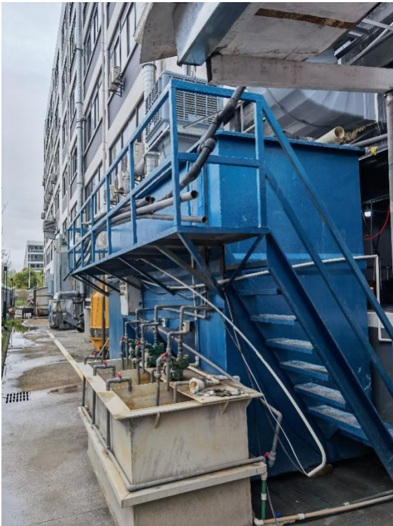
图 4.1-2 废水处理设施
