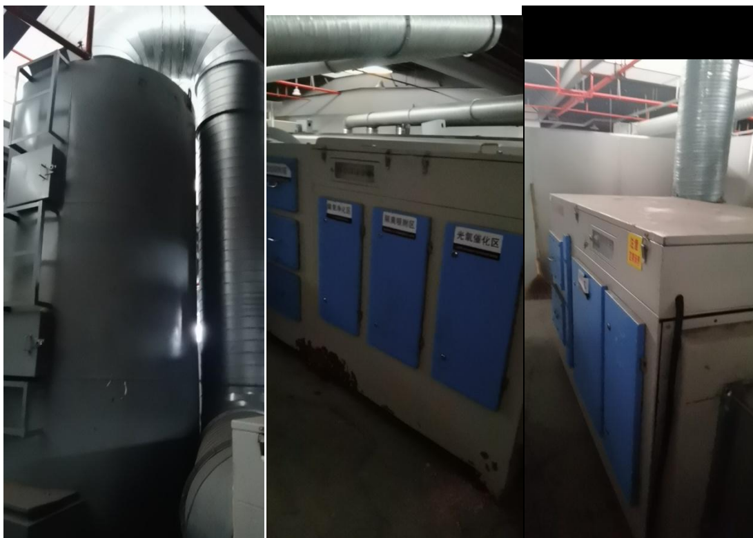
喷漆、烘干、调漆废气处理设备——水喷淋+光氧催化+活性炭吸附
