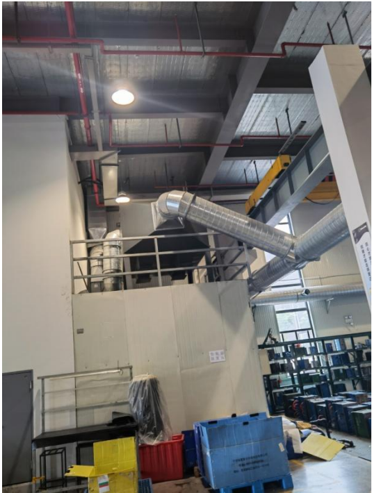
注塑废气处理设备——活性炭
