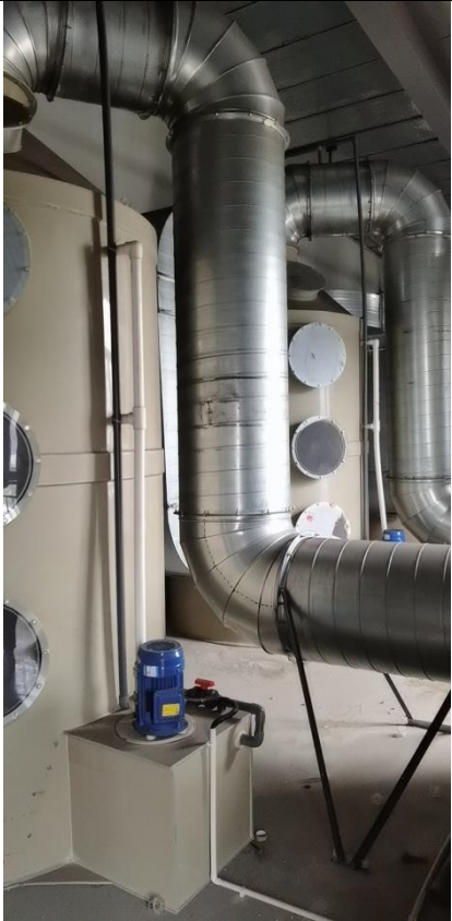
焊接烟尘处理设备——水喷淋
